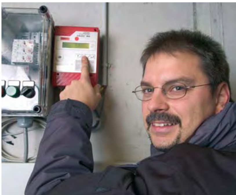
Martin Dietler, Energiecontractor: „Zusammen mit dem Betrieb einer Abwasser-Wärmepumpe übernehmen wir auch die individuelle Heizkosten-Abrechnung.“ (Foto EBM)
