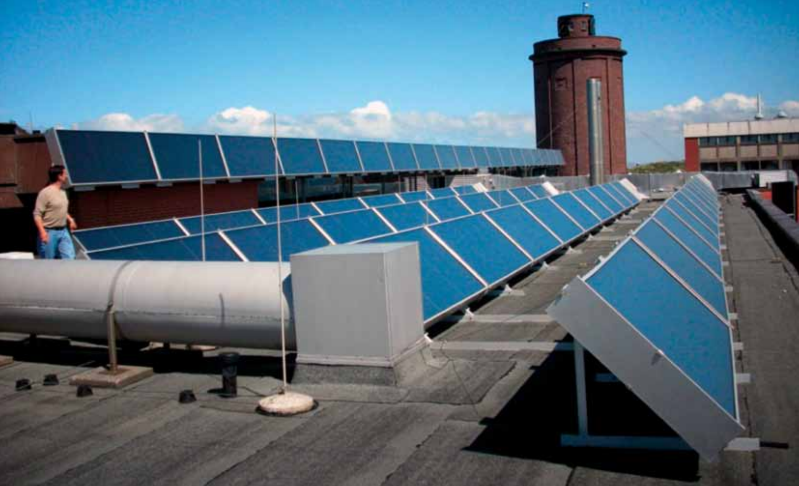
Wärmepumpen lassen sich gut mit Solaranlagen kombinieren. (Quelle: Inselgemeinde Juist)
