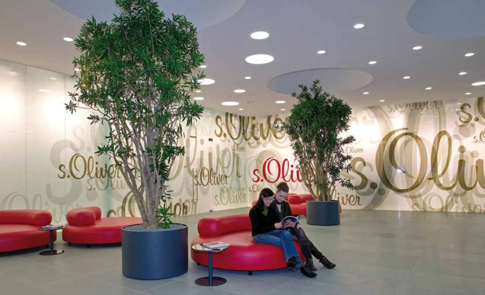
Gutes Arbeitsklima: Erdsonden sorgen über Kühldecken auch im Hochsommer äußerst energiesparend für angenehme Temperaturen. (Quelle: Glen Dimplex / Fotograf: Matthias Maas)
