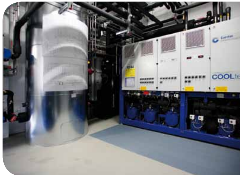
Zur Kühlung und Raumheizung wird die Temperatur im Erdreich mithilfe von Erdsonden genutzt. (Quelle: REWE Group)
