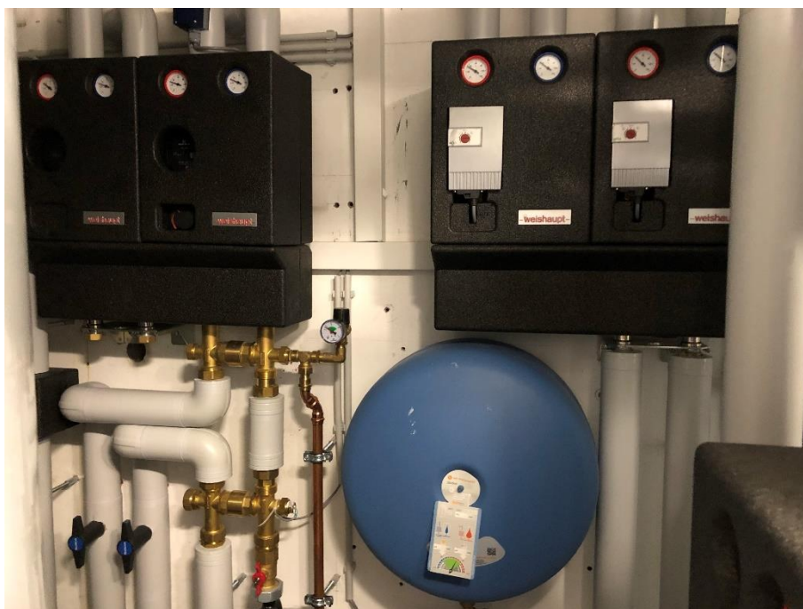
In Verbindung mit einer Solaranlage auf dem Dach erreicht die Wärmepumpe eine hohe Jahresarbeitszahl von 5,01. (Bildquelle: Massmann GmbH).
