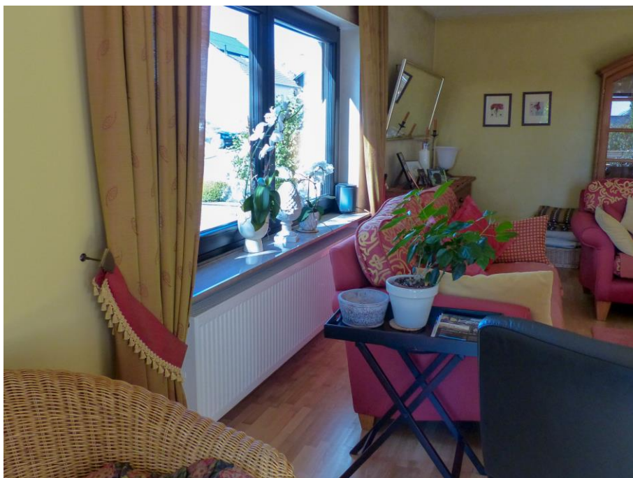
Anstelle alter Nachtspeicherheizungen heizen nun gut integrierte Flächenheizungen in Verbindung mit der Wärmepumpe hoch effizient. (Bildquelle: BWP)
