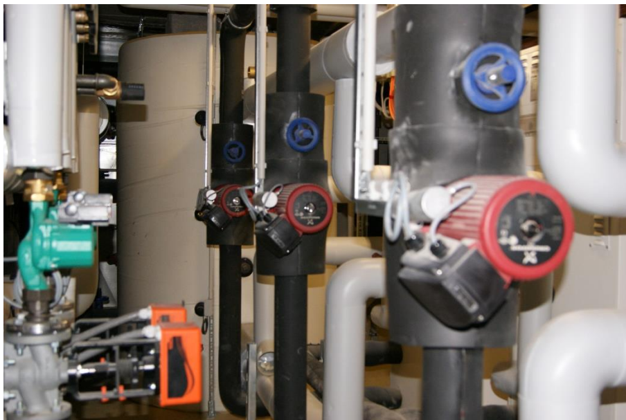
Optimal ausgelegte Systeme sorgen dafür, dass die Wärme- und Kälteversorgung in jeder Betriebssituation sichergestellt ist. (Bildquelle: Wagner GST GmbH).
