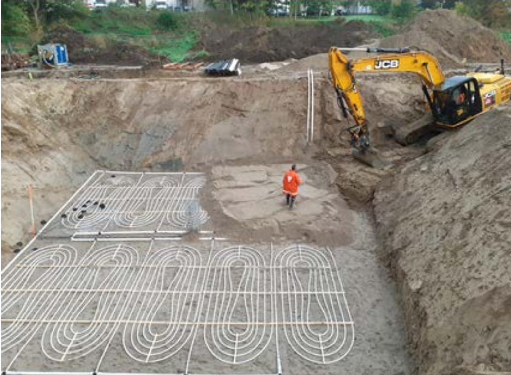
Erdkollektoren, Kaltes Nahwärme-Netz in Schleswig © Stadtwerke SH GmbH & Co. KG
