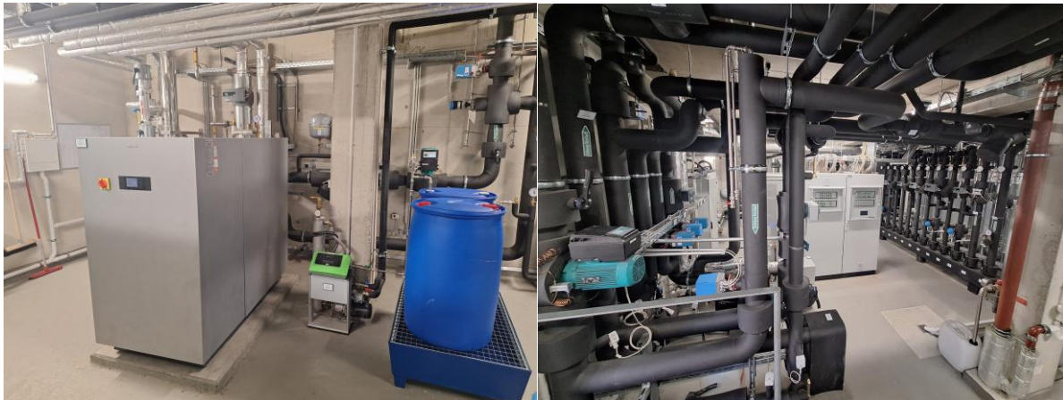
Herzstück des Gründerzentrums: Ein unterirdischer Eis-Energiespeicher in Kombination mit einer Sole-Wasser-Wärmepumpe, Solarkollektoren und einem intelligenten Regelungssystem. Fotos: Vitocal 300-G Pro C140, Thomas Troschitz (Carrier)
