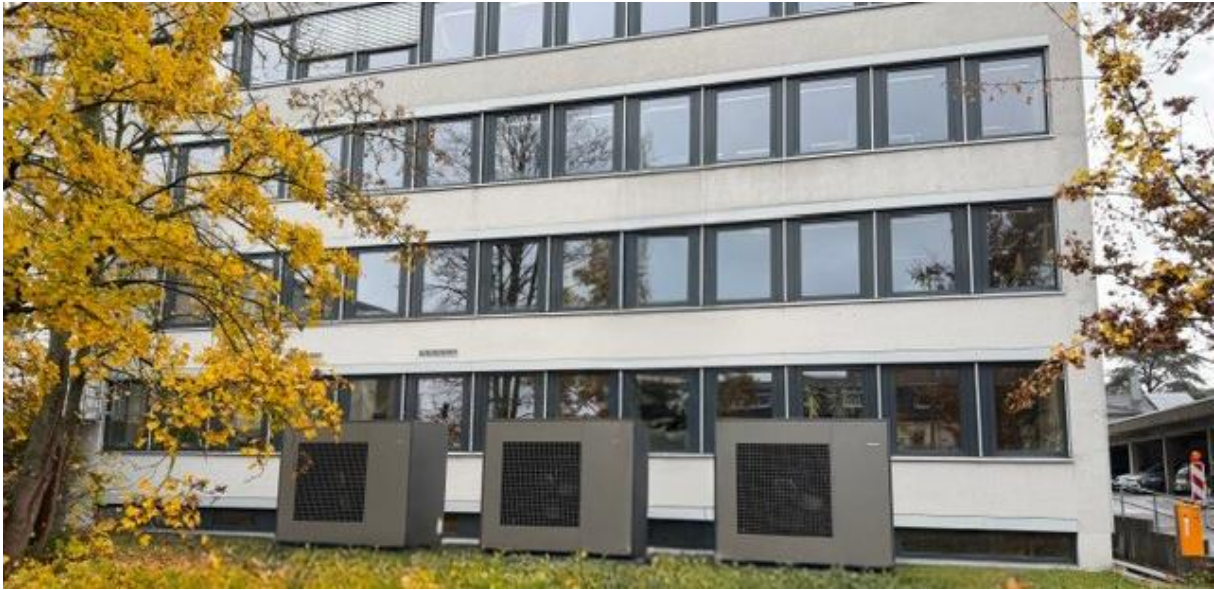
Die Außengeräte der drei moderne Luft-Wasser-Wärmepumpen mit dem klimafreundlichen Kältemittel R290 stehen auf der Freifläche vor dem Gebäude. Foto: Glen Dimplex
