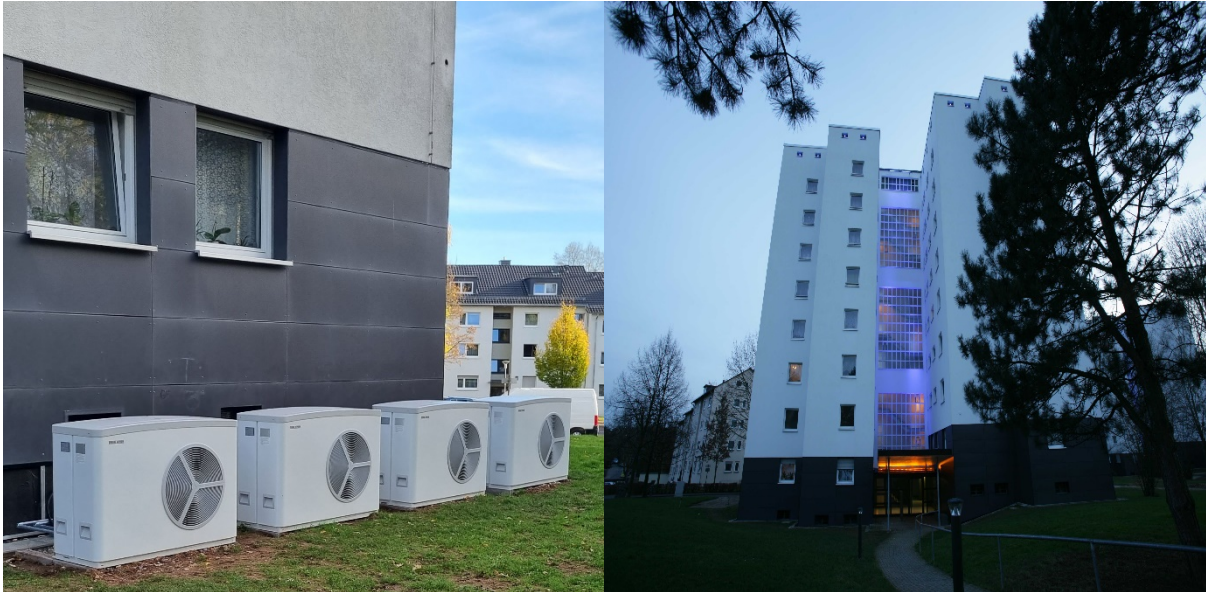
Installierte Wärmepumpen und der Eingangsbereich eines Modellgebäudes (Bildquelle GWG)
