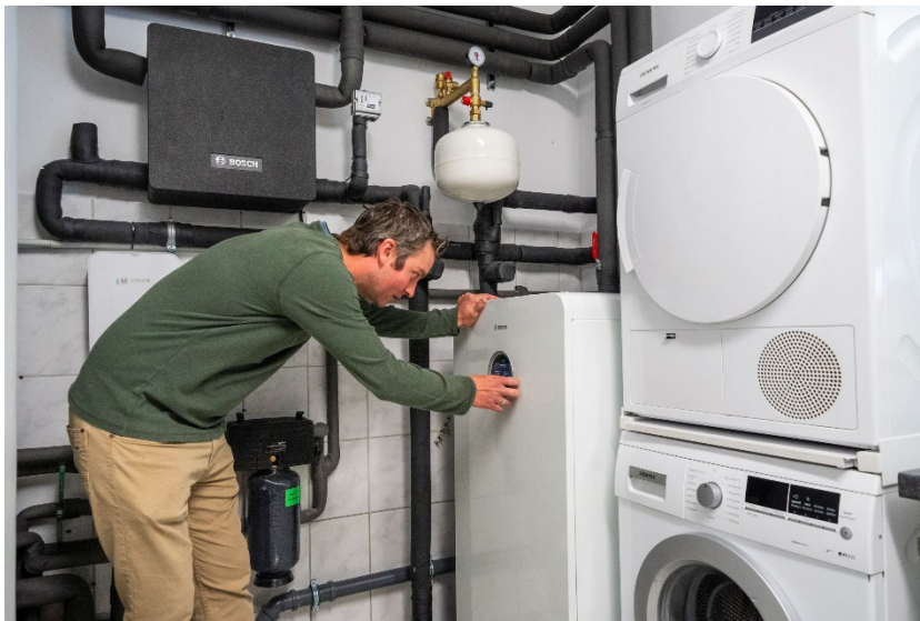
Bild 1: Der Wärmepumpen-Fachmann Kristof Lenders konnte in seinem Haus eine effiziente Anlage installieren mit einer JAZ von 5,4./BWP
