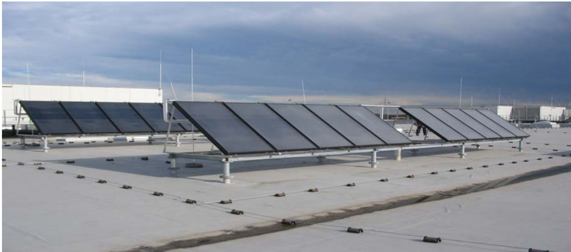
Solaranlage auf dem Dach von IKEA in Augsburg
